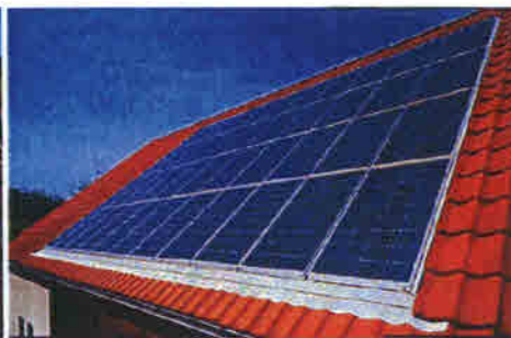
Un ensemble de panneaux photovoltaïques , dont la taille est variable, qui produit de l'électricité en courant continu
